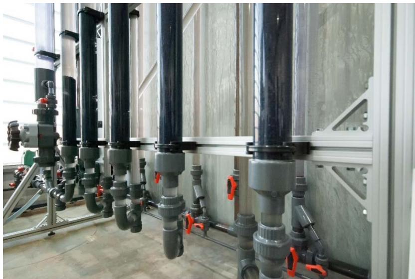
Versuchsanlage in Nahaufnahme
